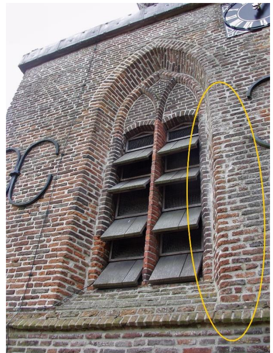
272. Slordigheden in voeg- en metselwerk rond de vensters.
