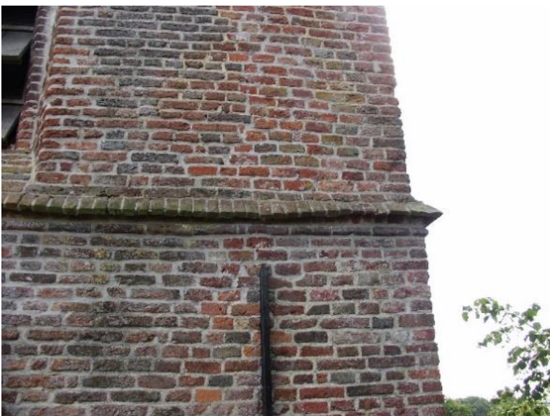
273. Noordgevel op grens tweede en derde geleding: grote verschillen in metselwerk, staand verband links, een soort koppenverband rechts.
