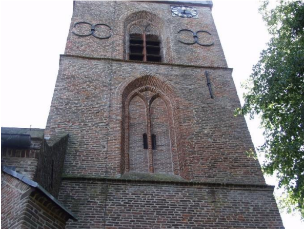
270,. Rondom alle gotische vensters en blindvensters zijn slordigheden en kleurverschillen in het metselwerk te zien. Vooral bij de vensters in de noordgevel is dit zeer duidelijk.
