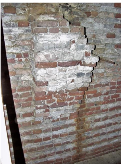
232. Brok metselwerk boven triomfboog.
