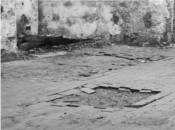
130. Vloer na de brand.
