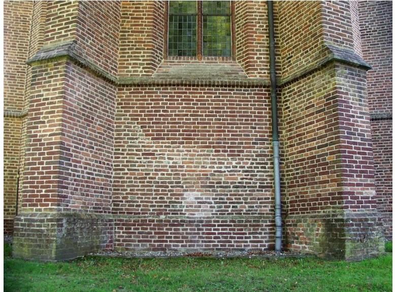
79. Opzichtig inboetwerk en 'hersteld' voegwerk uit verschillende restauraties.
