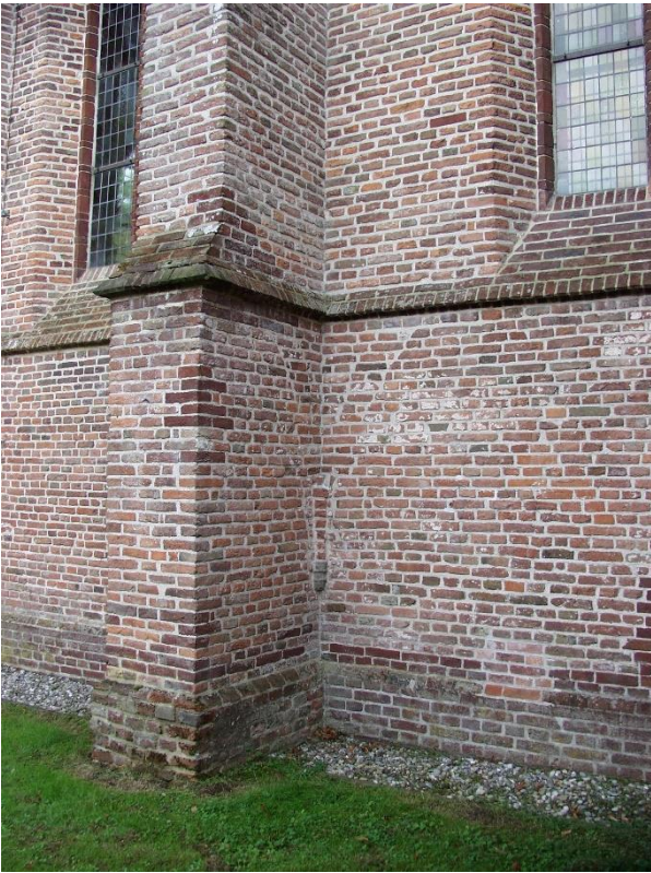
98 De steunbeer maakte ooit deel uit van de oostgevel van de sacristie.
