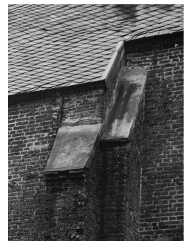
89 - 90. De afstand tussen het dak en de afzaat van de linker steunbeer was groter. Ook de inzwenging van de gevel onder het dak is niet origineel.
