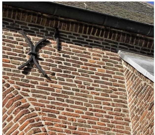
95. De rechte muurankers behoren bij de liggers boven de koorgewelven. De X-vormige ankers vervullen in de huidige balkconstructie geen functie meer.
